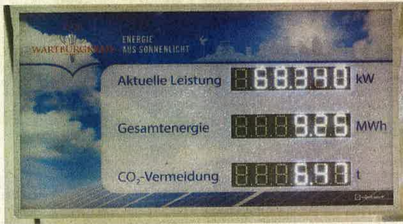
Eine Tafel im Eingangsbereich des Gebäudes zeigt die Aktivität der Photovoltaikanlage.
